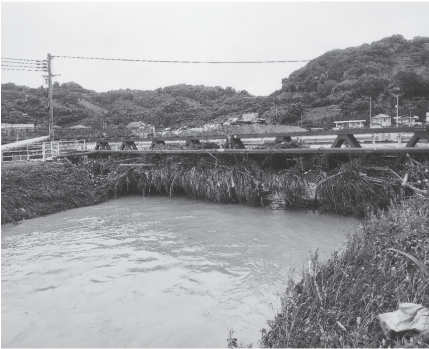
大量の草が掛かった下津町方の仮橋（6月3日）
