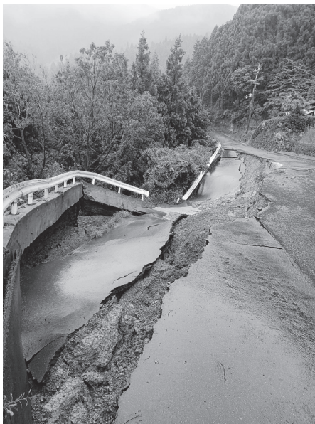
紀美野町上ヶ井の道路陥没
